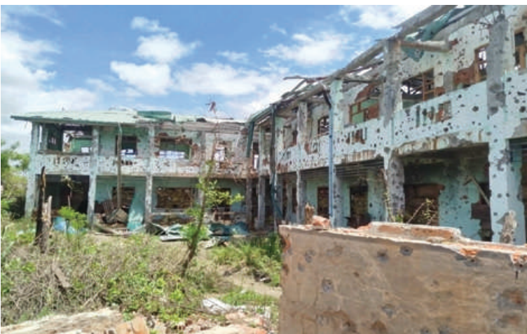
ထန်တလန်မြို့ အမှတ်(၁) အခြေခံပညာအလယ်တန်းကျောင်း ပျက်စီးနေမှုကို တွေ့ရစဉ်။
